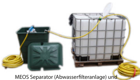
MEOS Separator (Abwasserfilteranlage) und 1000 l Tank
